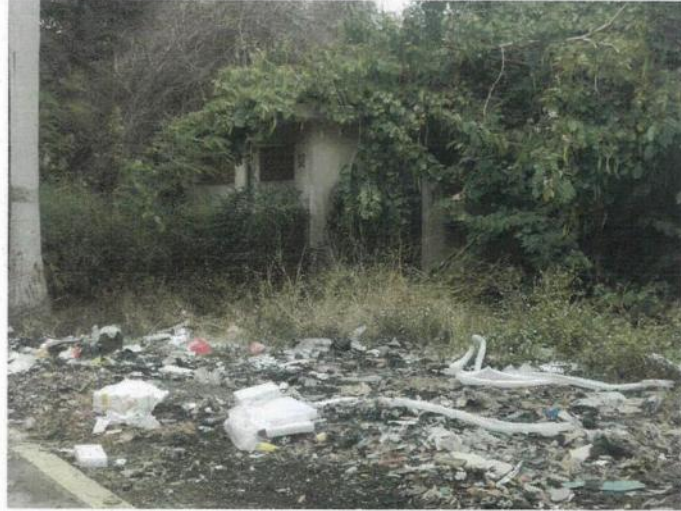
图 3 原怡海园内废弃的厕所
